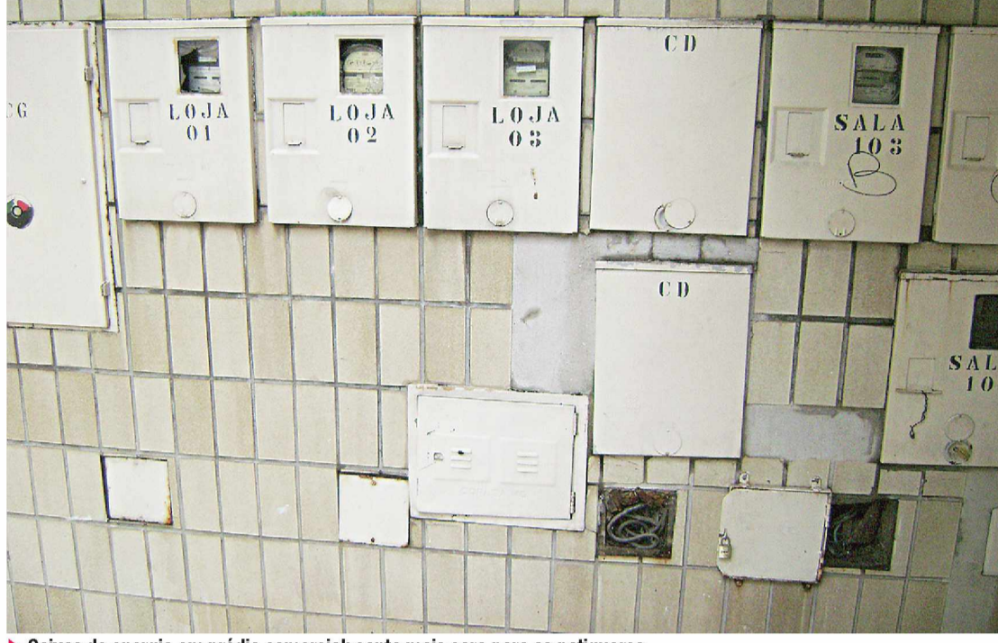
▶ Caixas de energia em prédio comercial: conta mais cara para os potiguares
