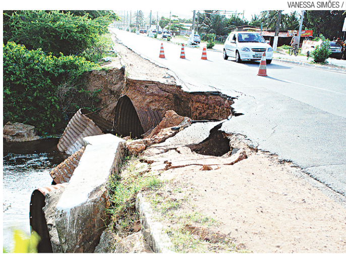
▶ Trecho da avenida cedeu ontem à tarde
