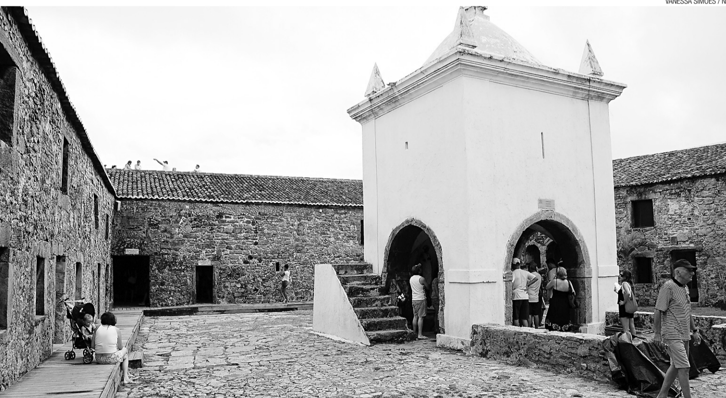
► Forte dos Reis Magos, com problemas estruturais, vai passar por uma reforma, conforme garante a Fundação José Augusto
