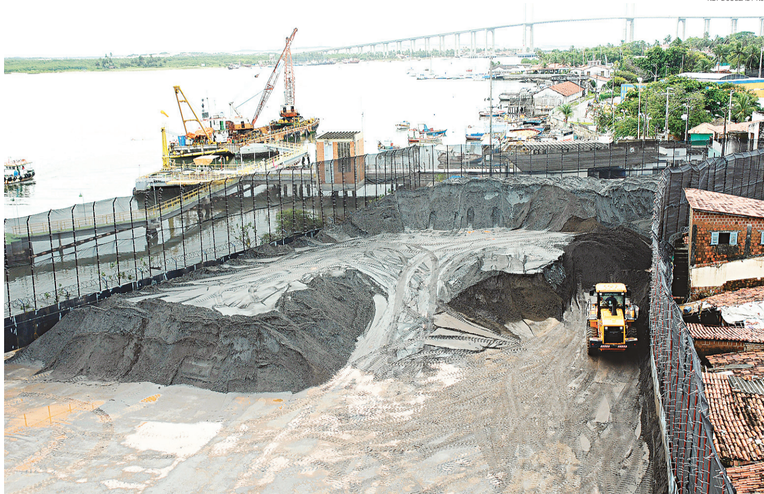
► Armazenamento de minério da forma como é feita terá de ser revista
