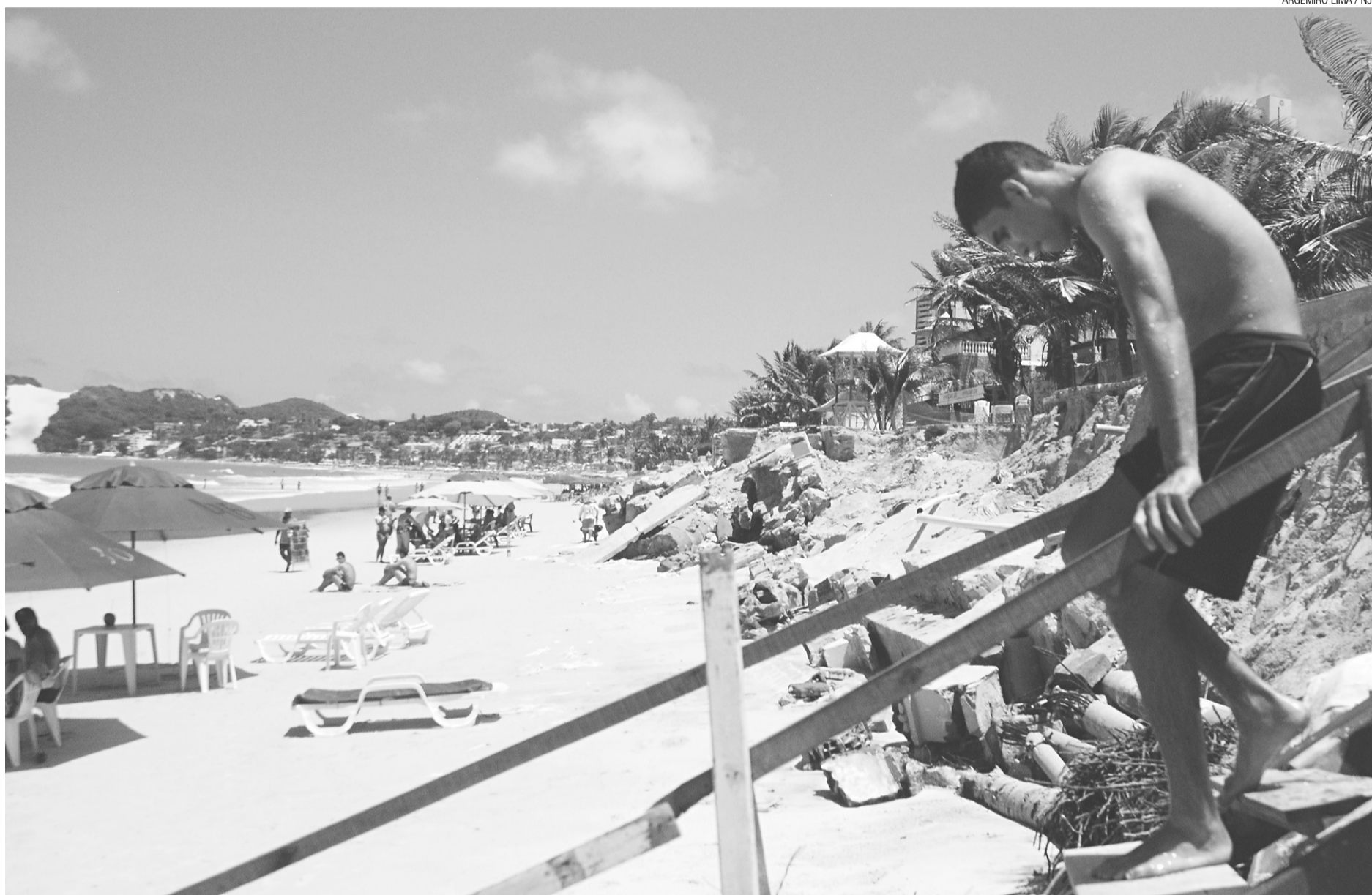
▶ Desde que o calçadão começou a ceder em razão da força da maré, em meados do ano passado, a destruição se espalhou em vários pontos de Ponta Negra
