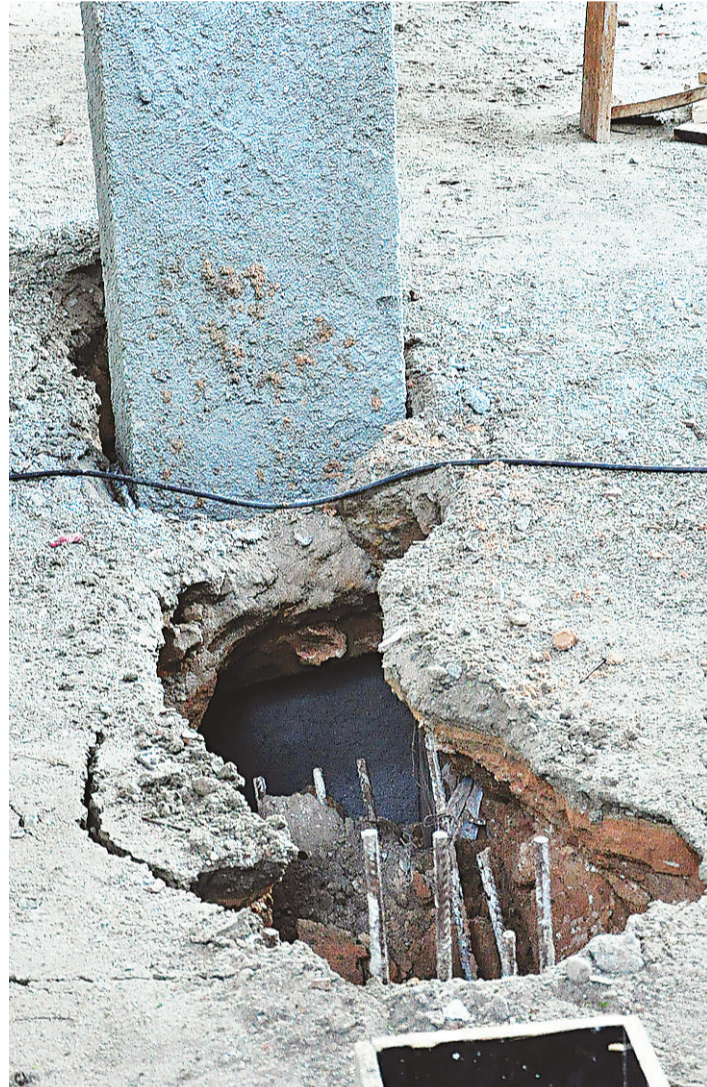
Um dos pilares do prédio afundou no solo
