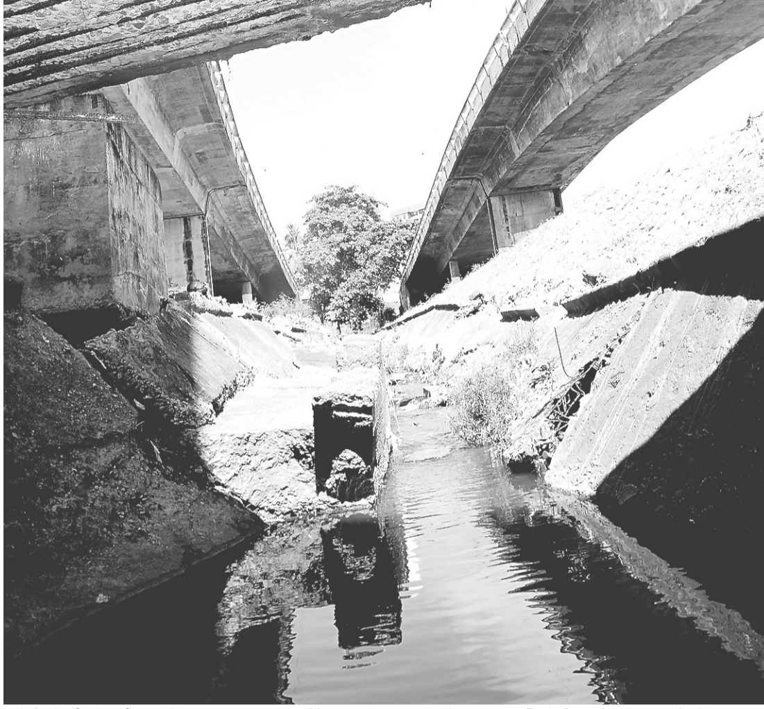
► Laje do túnel está completamente comprometida: concreto que recobre a armação de ferro desabou no riacho
