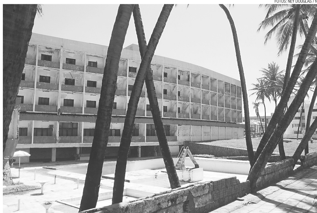
► Sem manutenção, Hotel Reis Magos tem infiltrações e ferragens expostas: grupo controlador perdeu investimentos
