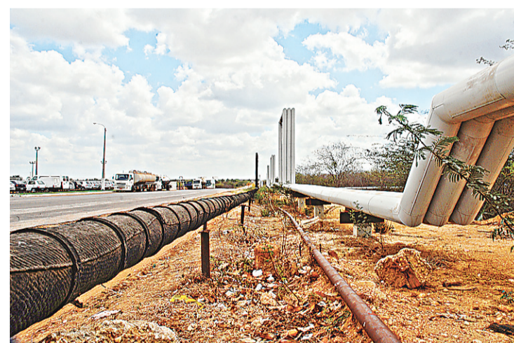
▶ Dutos de bombeamento de petróleo na região Oeste: campos maduros
