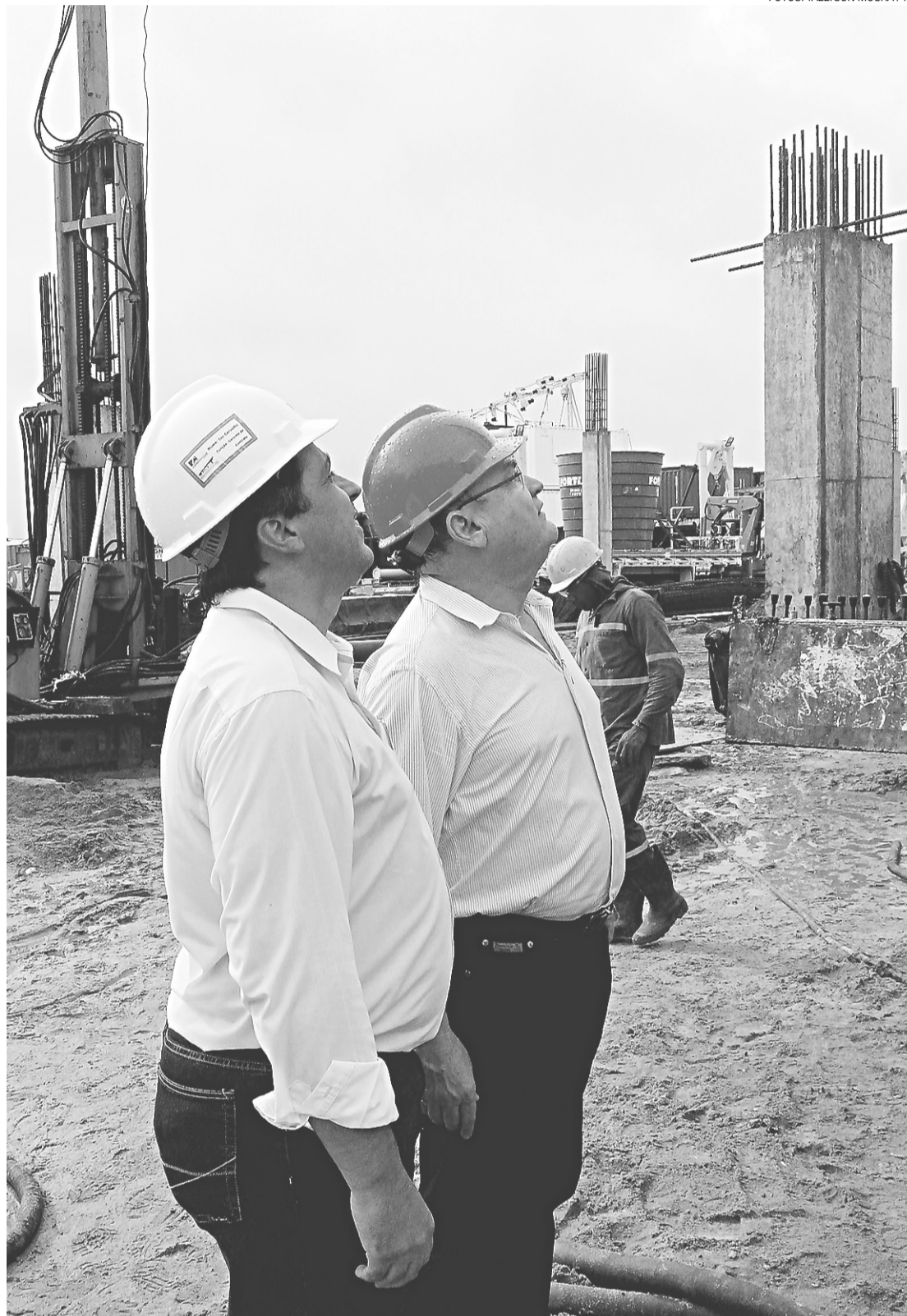
► O engenheiro Ivo Carvalho, da Constremac, e o diretor presidente da Codern, Pedro Terceiro, observam obra no porto
