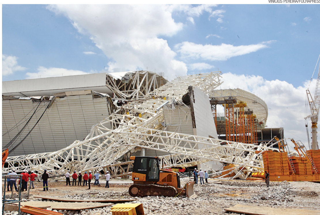
► Cobertura desabou do guindaste e destruiu parte da arquibancada
