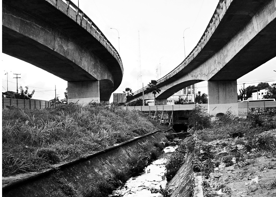
▶ Trecho sob a Avenida Deodoro da Fonseca, por onde deve começar o escoramento, é o mais crítico do canal
