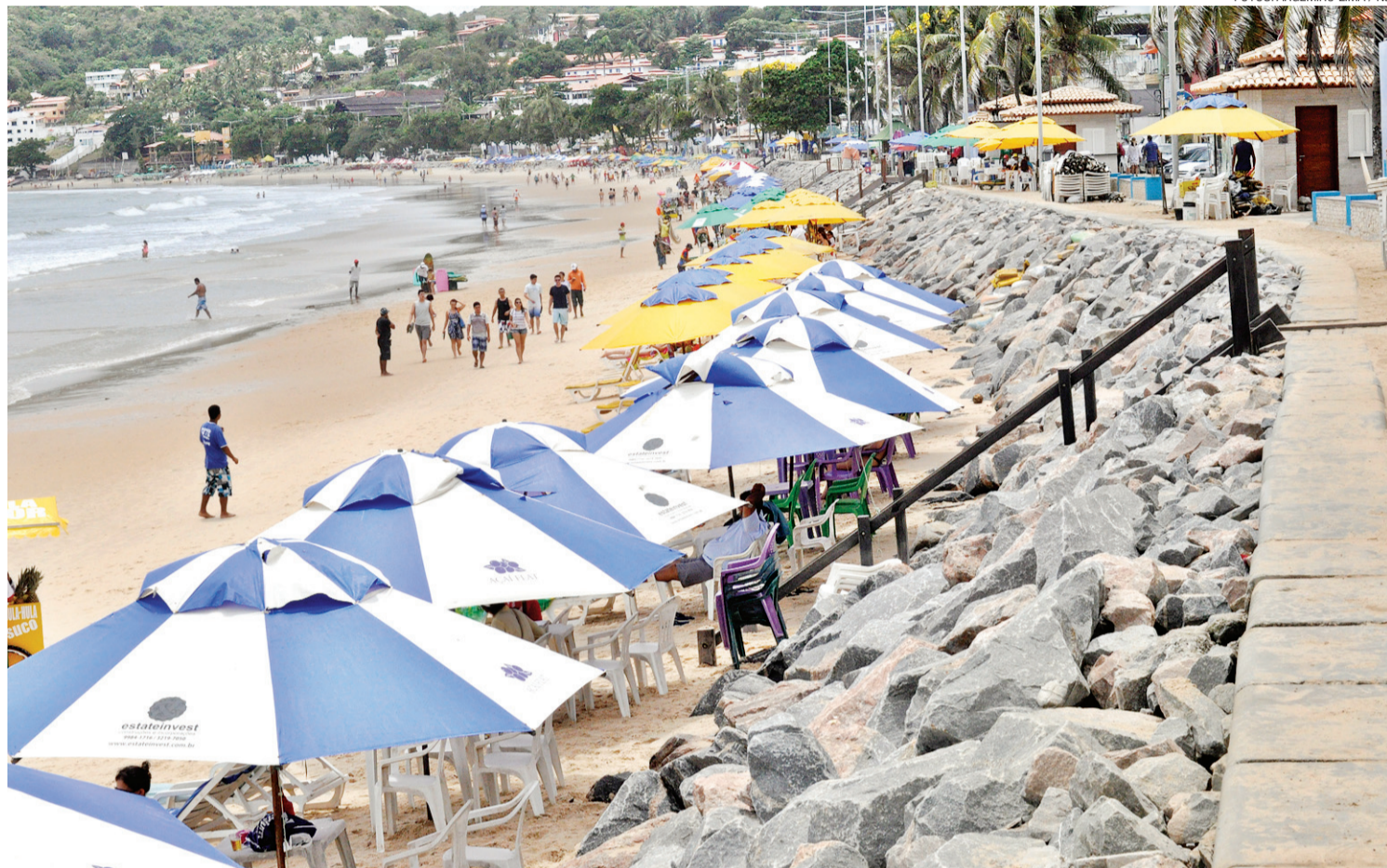
► Obra de proteção do calçadão de Ponta Negra: pedras dentro da medida prevista, afirmam os responsáveis pelo projeto
