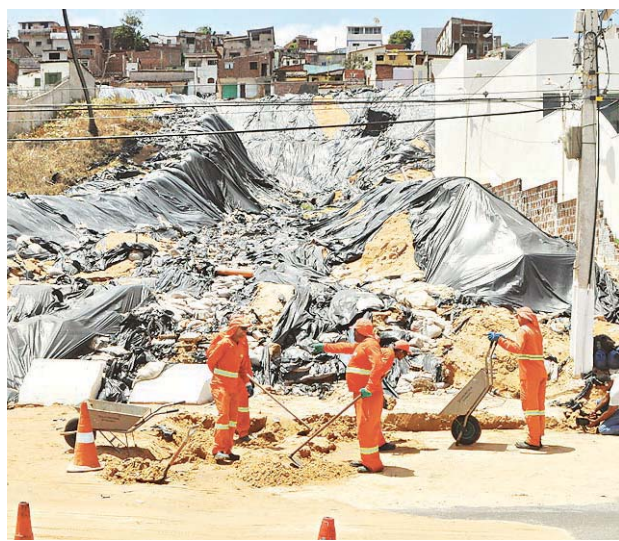
Problema em tubulação provocou deslizamento em Areia Preta
