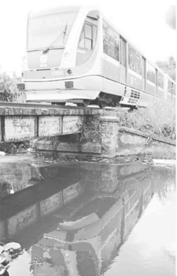
▶ Ponte em que o VLT atravessa o rio no bairro do Planalto
