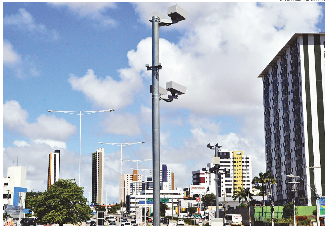
► Pardal já em fase de instalação está localizado perto da passarela do bairro Potilândia
