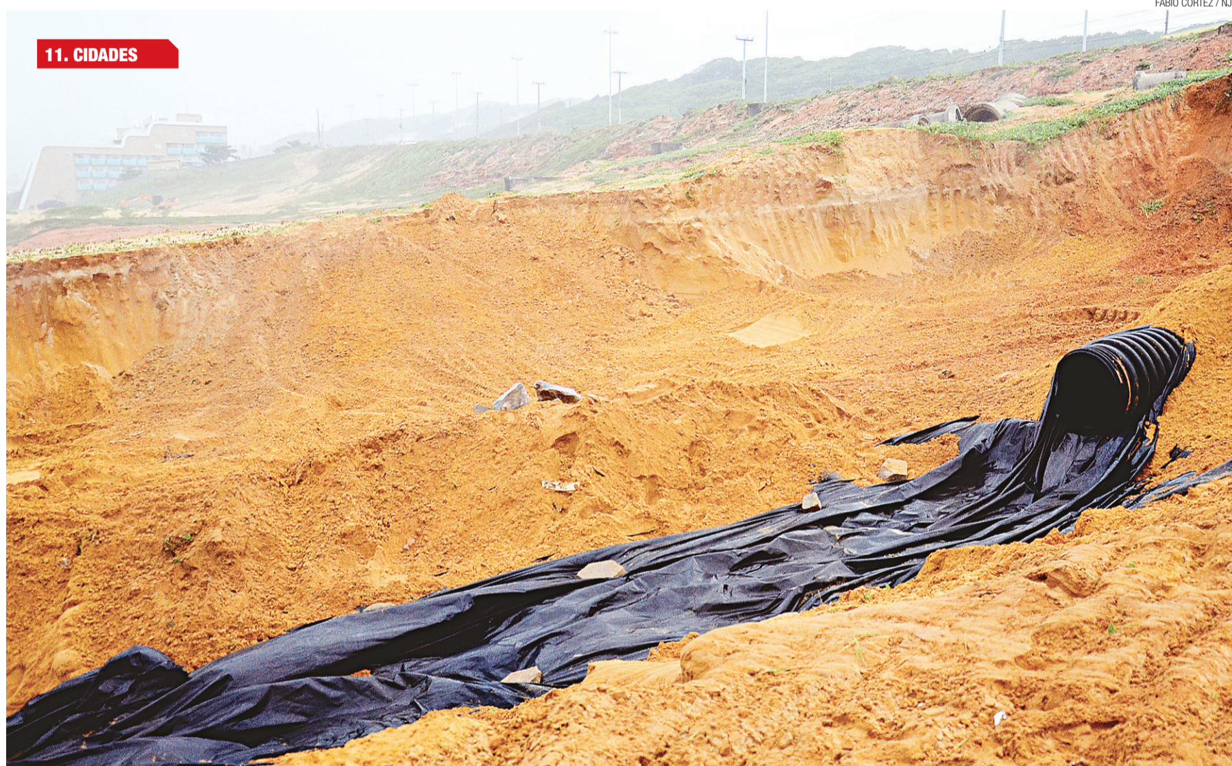
► Além de aterro, foi instalada nova tubulação e lonas para evitar que a água das chuvas continue provocando erosão na área localizada entre os hotéis Pestana e Serfis
