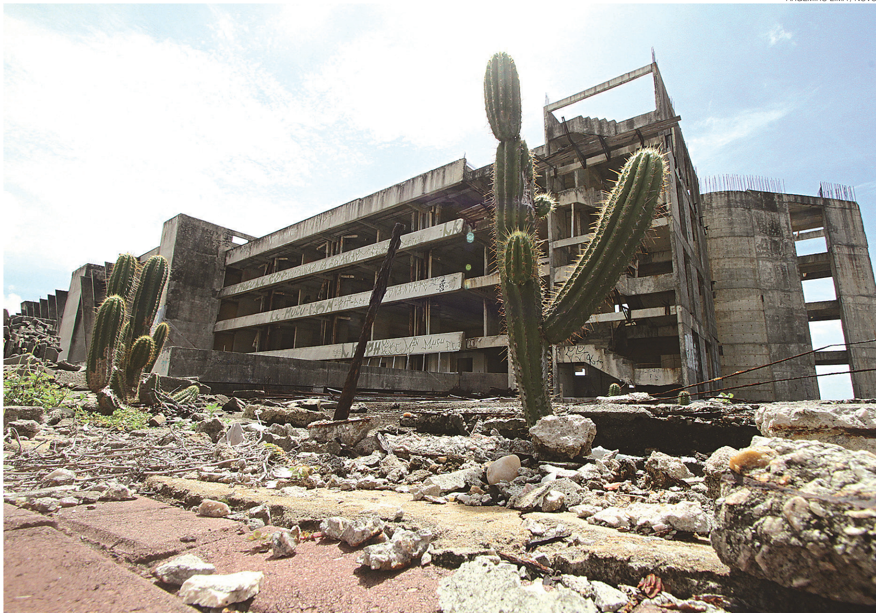
// Obras do hotel foram paralisadas em junho de 2006; primeiro pedido de suspensão foi feito pela prefeitura que alegou descumprimento das normas do Plano Diretor de Natal
