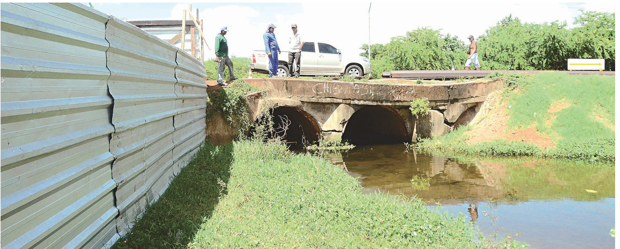
// Enquanto as obras de recuperação do pontilhão sobre o Rio Doce não são concluídas, o trânsito, principalmente de veículos pesados, continua causando transtornos aos motoristas nas horas de maior movimento
