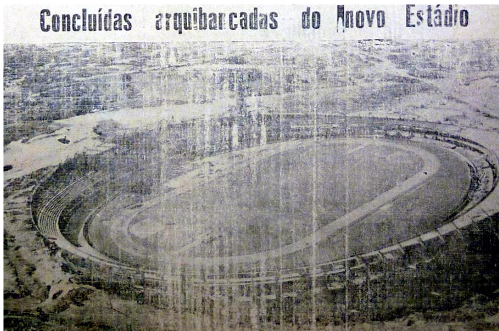
Figura 9 - Estádio Presidente Castelo Branco há aproximadamente três meses antes da data estipulada para a finalização das obras.
