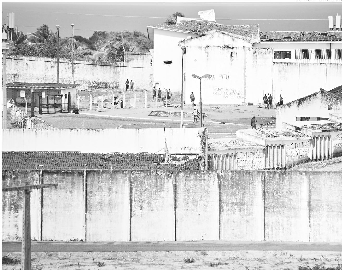
// Estrutura de Alcaçuz está severamente deteriorada após série de motins e, por isso, governo considera reforma financeiramente inviável
