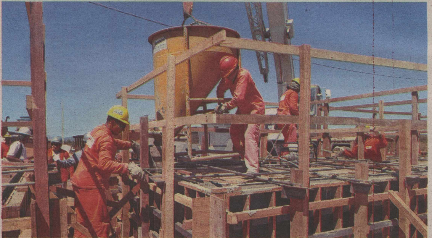
Obras englobam conceitos de sustentabilidade quanto ao uso racional dos recursos naturais e compra de materiais ambientalmente corretos
