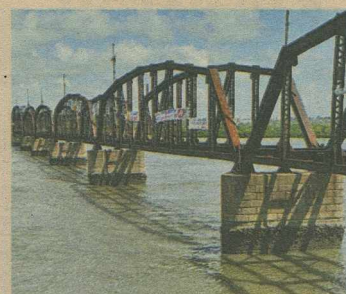
Estrutura não tem manutenção
