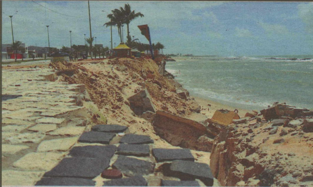
Passagem de pedestres na orla central ruiu parcialmente em função do contato com o mar
