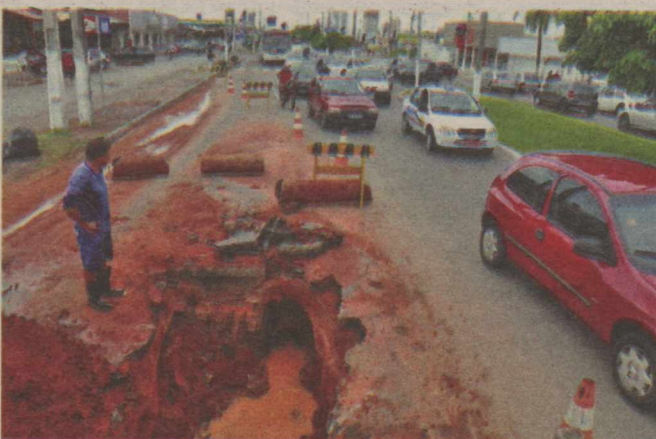
Buraco aberto por causa de problemas na tubulação causaram lentidão
