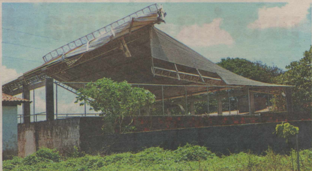
Na última sexta-feira, vento destruiu parte da cobertura, envergou a estrutura metálica e arrancou placas de alumínio
