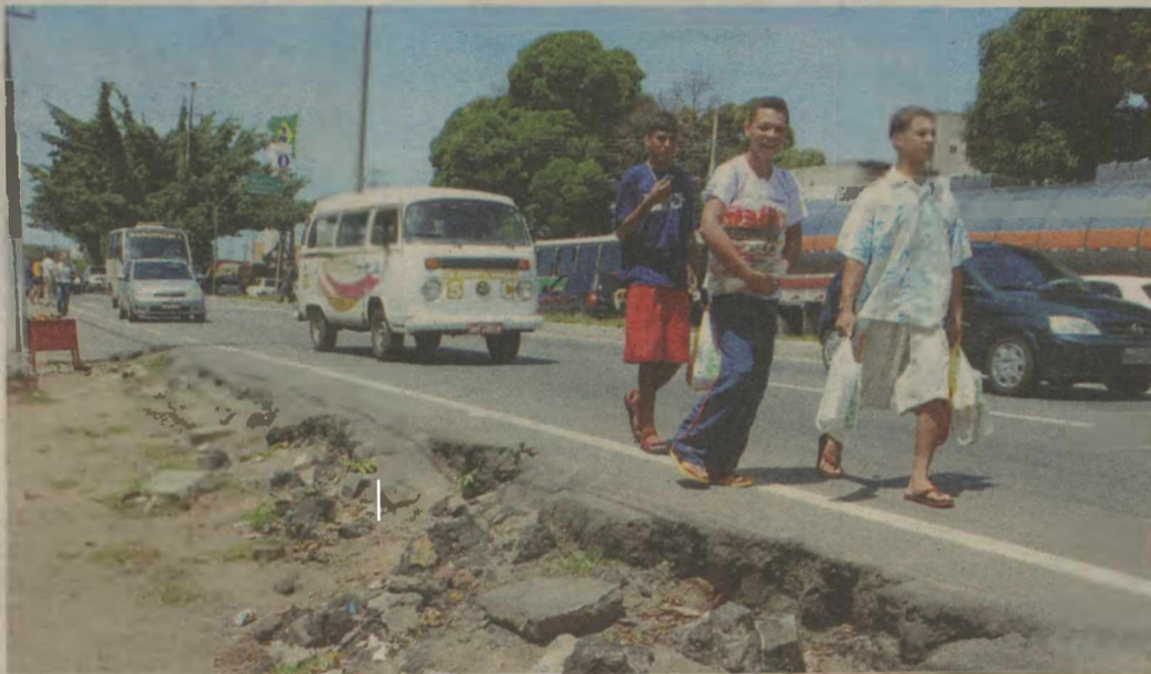
Na Avenida Tomaz Landim, não há passeio público e a população tem que dividir espaço com veículos
