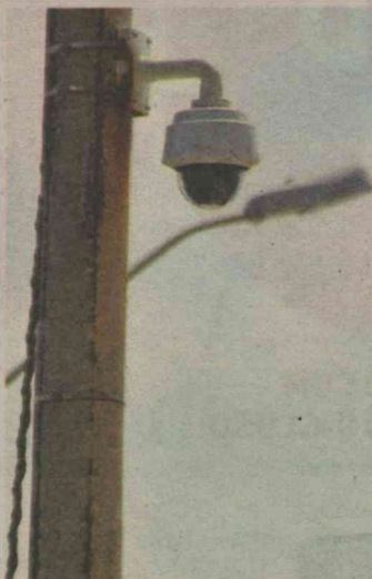
Foram instalados 30 equipamentos
