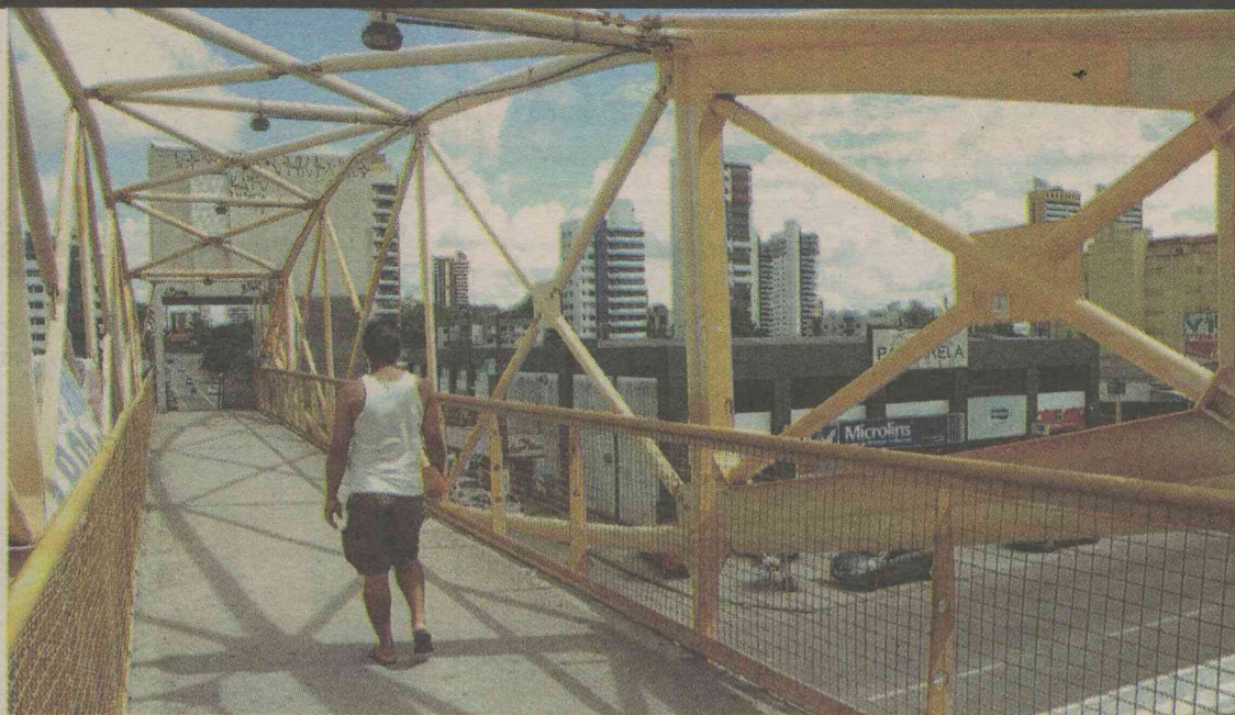
Grades desgastadas, lixo e um elevador desativado desde 2007 são alguns dos problemas do equipamento
