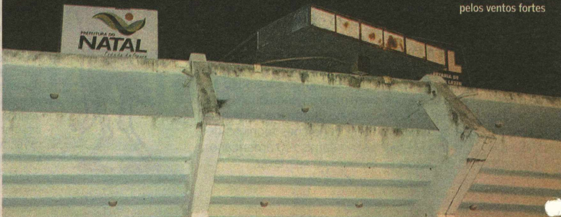
Base corroída pela maresia facilitou a queda provocada pelos ventos fortes
