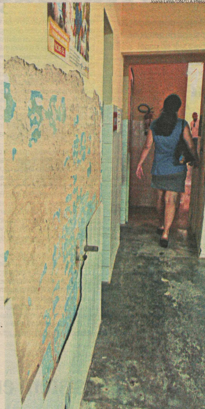
Unidade em mau estado na Cidade Satélite: face mais visível do problema
