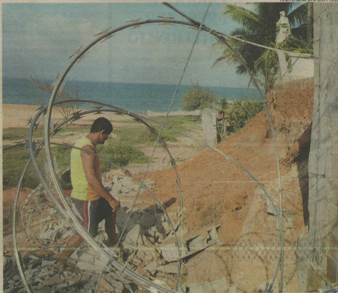
Parte da estrutura construída pelo Centro de Lançamento desabou na madrugada de quarta para quinta-feira
