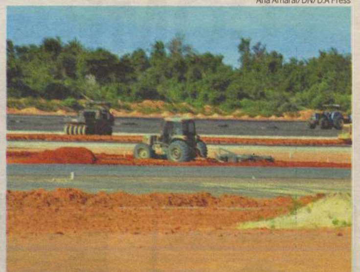
Expectativa do governo é de que construção seja entregue no início de 2014
