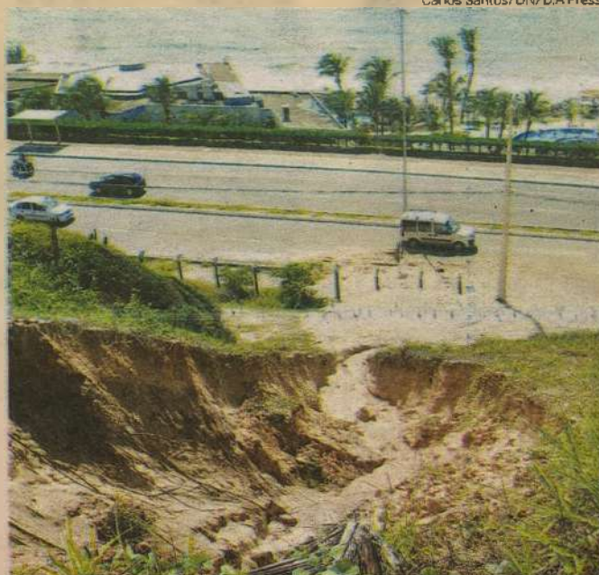
DER aponta drenagem inadequada como uma das causas do incidente
