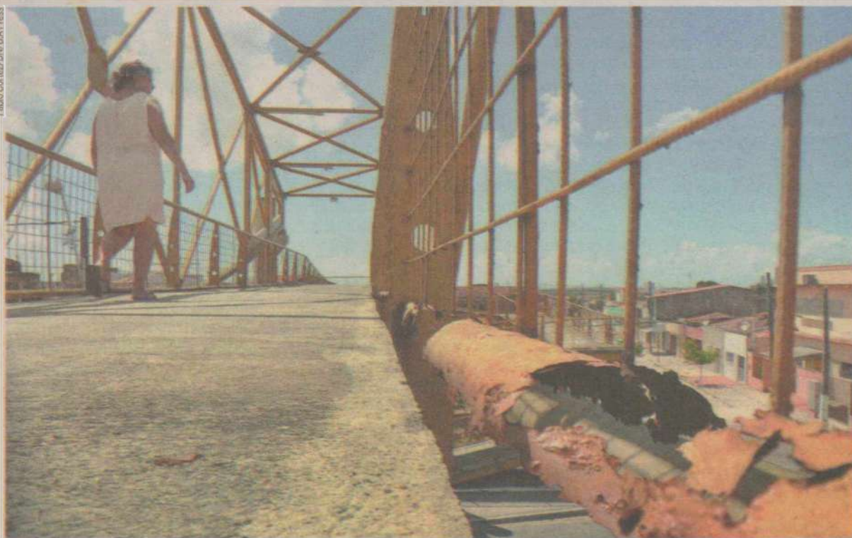
CORROÍDA // Passarela de metal sobre a Avenida Bernardo Vieira apresenta risco aos pedestres. PÁGINA 2
