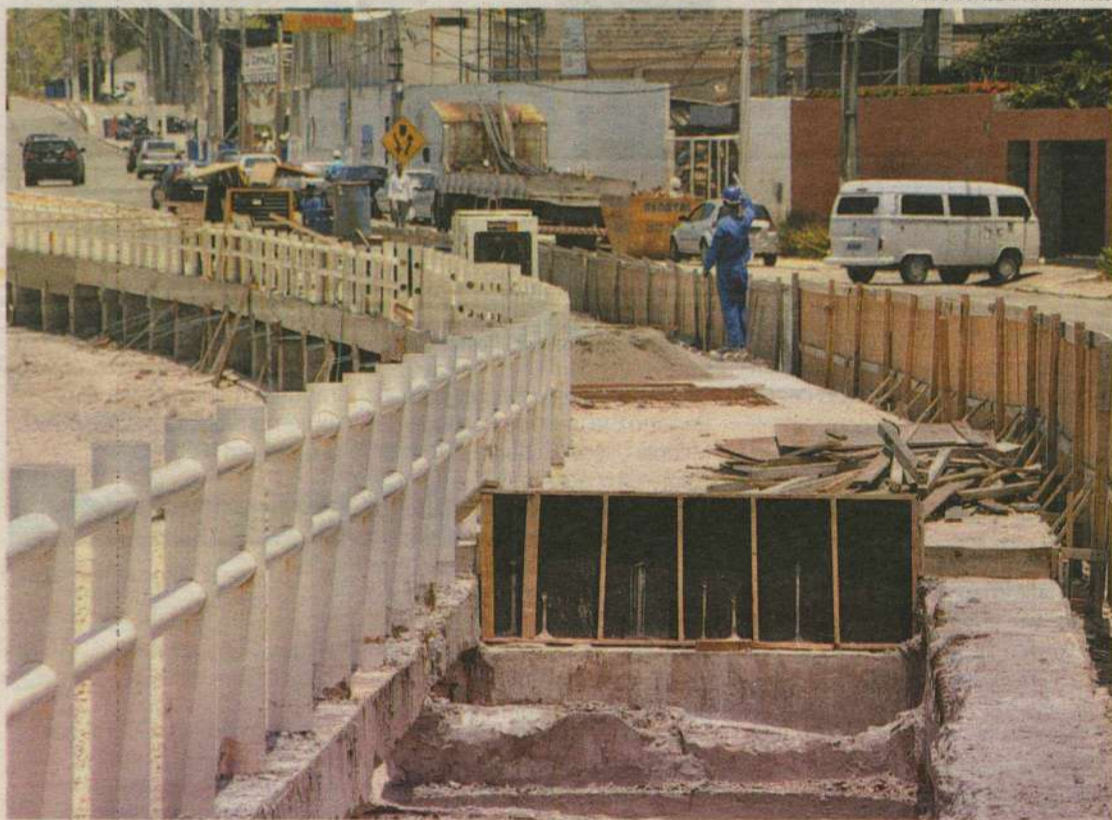
PRAZO VENCIDO // Obras do calçamento de Areia Preta se arrastam sem conclusão. PÁGINA 7
