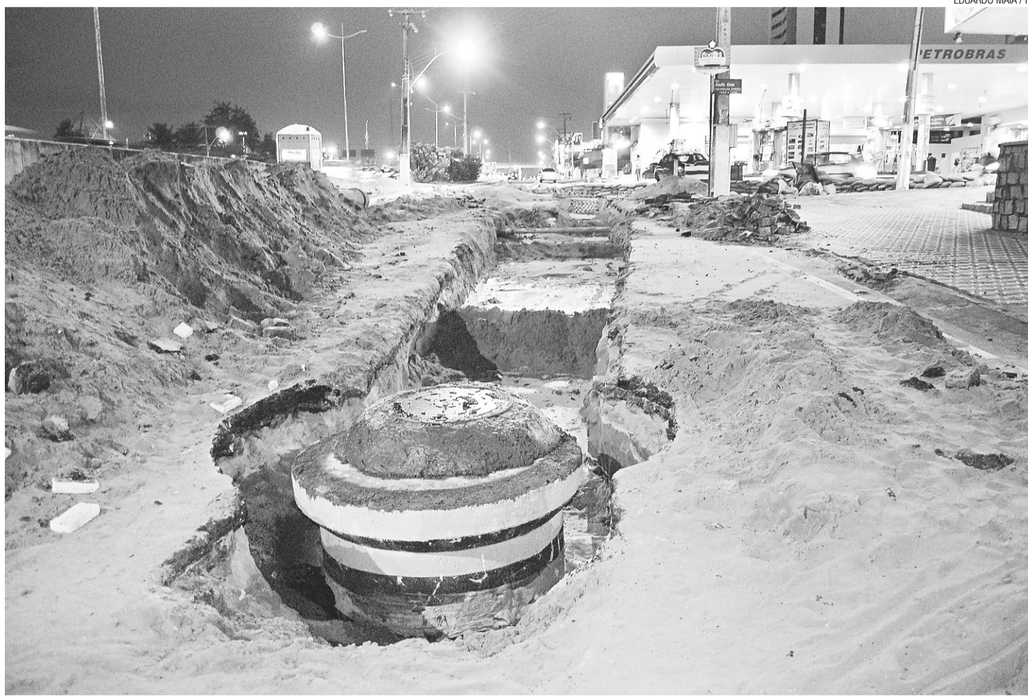
► Obra de esgotamento sanitário no bairro de Candelária: contrapartida com recursos próprios
