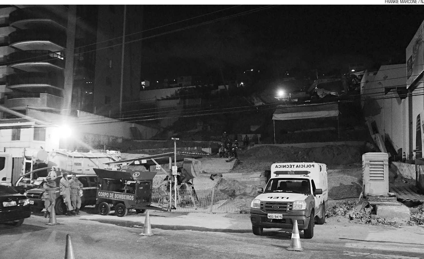
► Corpo do pedreiro Kleber do Nascimento foi localizado e trabalho de resgate prosseguiu durante a noite
