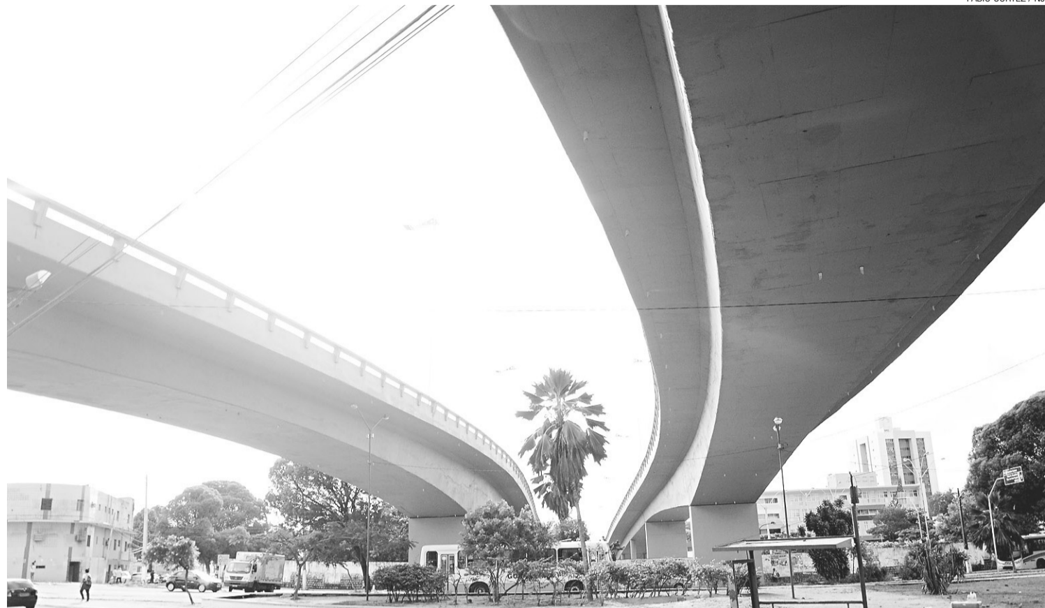
▶ Viaduto do Baldo, no Centro da cidade, está interdito desde 2009 e coleciona seguidos atrasos na sua conclusão
