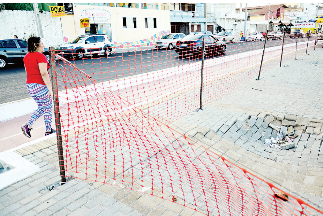
//TRECHO INTERDITADO - Num trecho do calçadão perto do Centro de Artesanato da Praia dos Artistas um cercado de madeira com telas vermelhas alerta à população: perigo de desmoronamento. Parte da calçada está deteriorada, precisando de recuperação. Para passar pela área, é preciso desviar o caminho descendo para a faixa de corrida e bicicletas.
