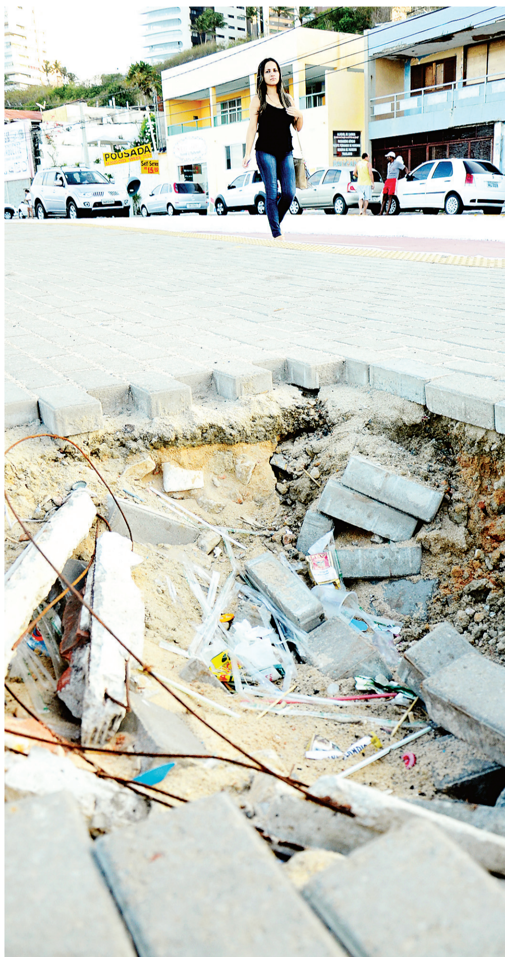
//BURACO NO CAMINHO - Um pouco mais à frente do calçadão, próximo à Casa do Matuto, um buraco de aproximadamente um metro quadrado surpreende os transeuntes. O pior é que o afundamento na calçada não tem qualquer sinalização, podendo provocar um acidente aos distraídos que passarem pelo local.
