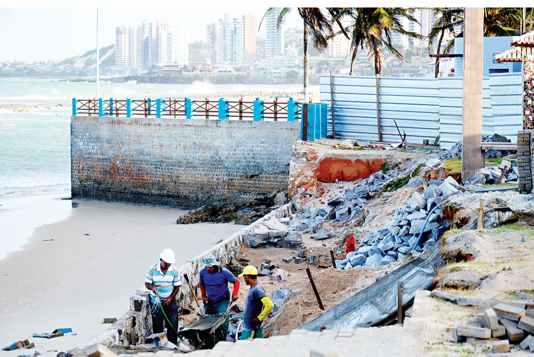
//OUTRA INTERDIÇÃO - No final do calçadão, já perto da quadra de esportes que fica à margem do viaduto que dá acesso à Ponte Newton Navarro, mais uma interdição. Tapumes de metal indicam que é proibida a passagem no local. O trecho interditado é maior que os demais, mas o problema é o mesmo: a calçada cedeu pela força do mar.
