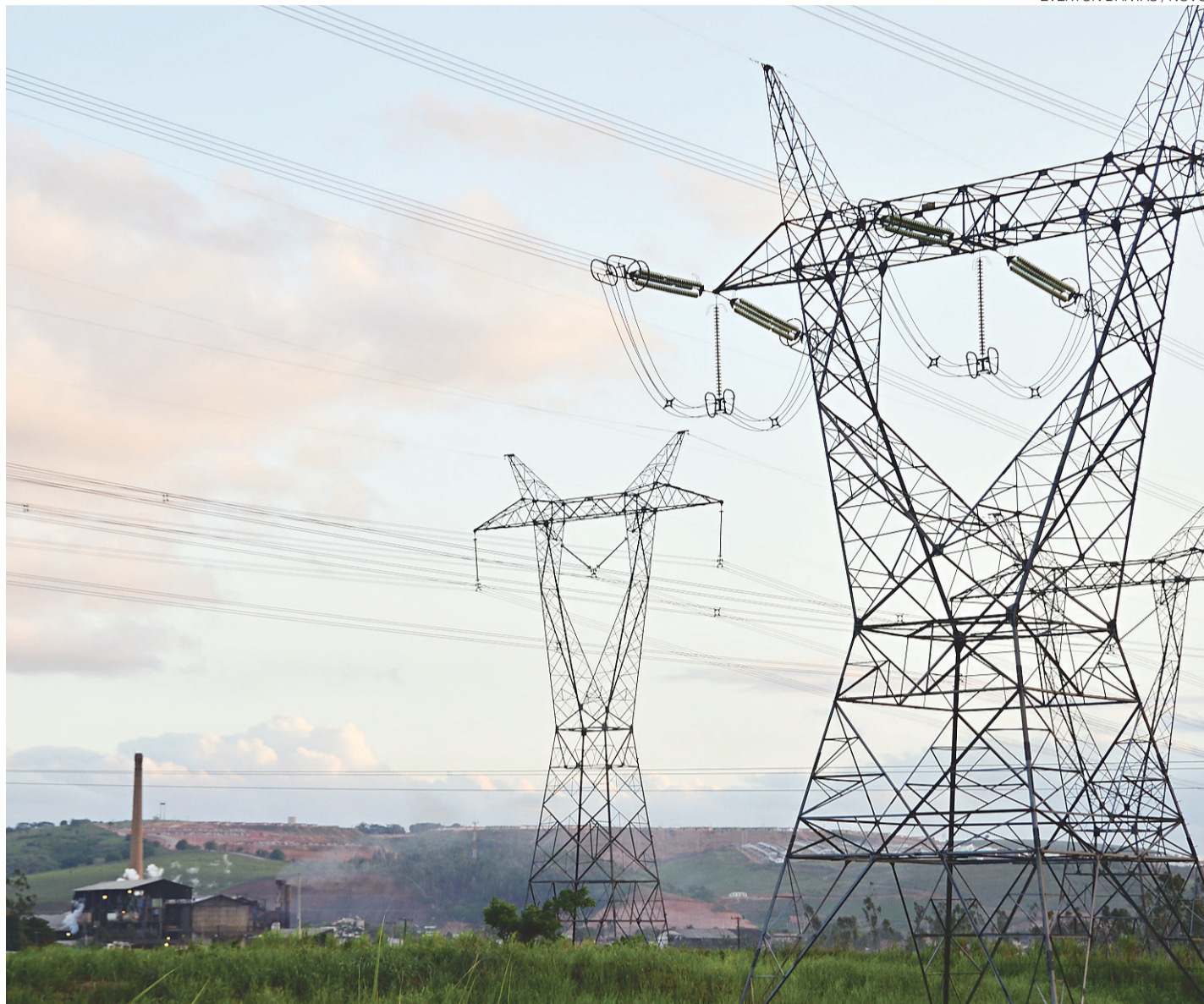
// Superintendência de Fiscalização dos Serviços de Eletricidade da Aneel acompanha o andamento de 363 empreendimentos em expansão
