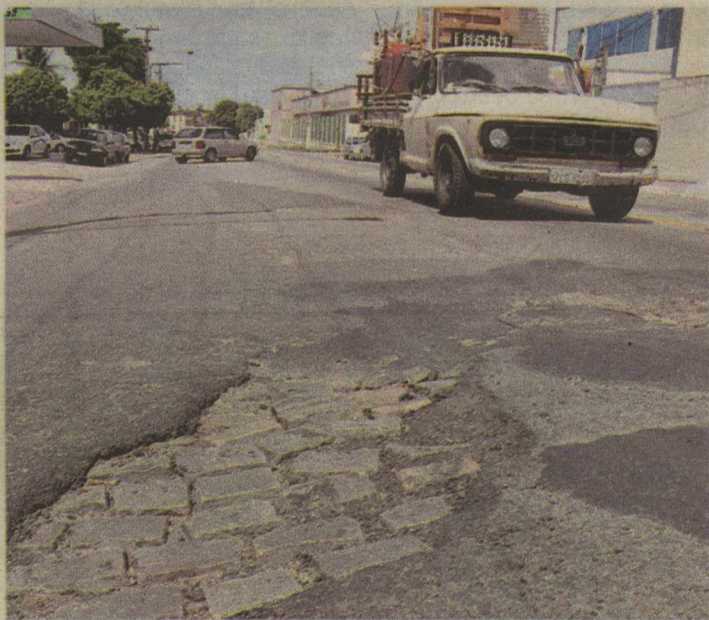
Mais de 30 buracos podem ser vistos numa extensão de 2km
