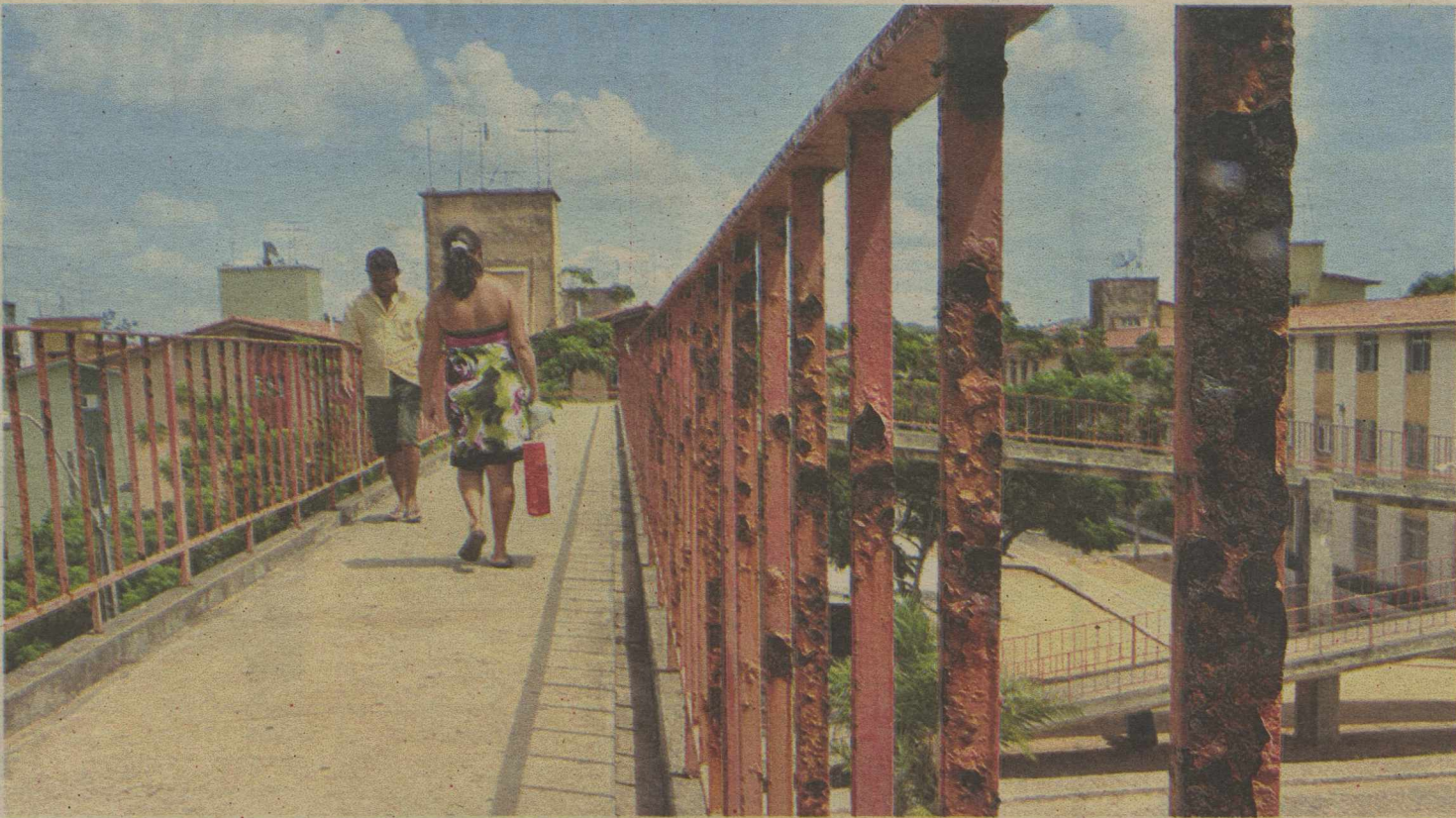
As péssimas condições das passarelas fazem com que esses locais, que deveriam transportar as pessoas, fiquem desertos. Insegurança é um grande problema
