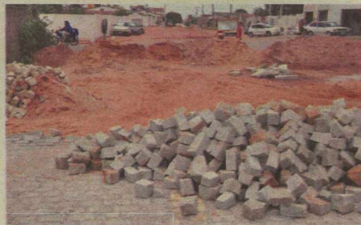
Parte da rua foi pavimentada, mas não drenada. Em outro ponto, situação se inverte
