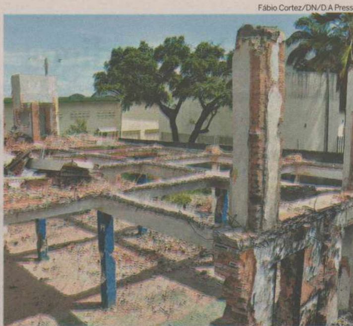
Vândalos atacam estrutura degradada e saqueiam material de construção
