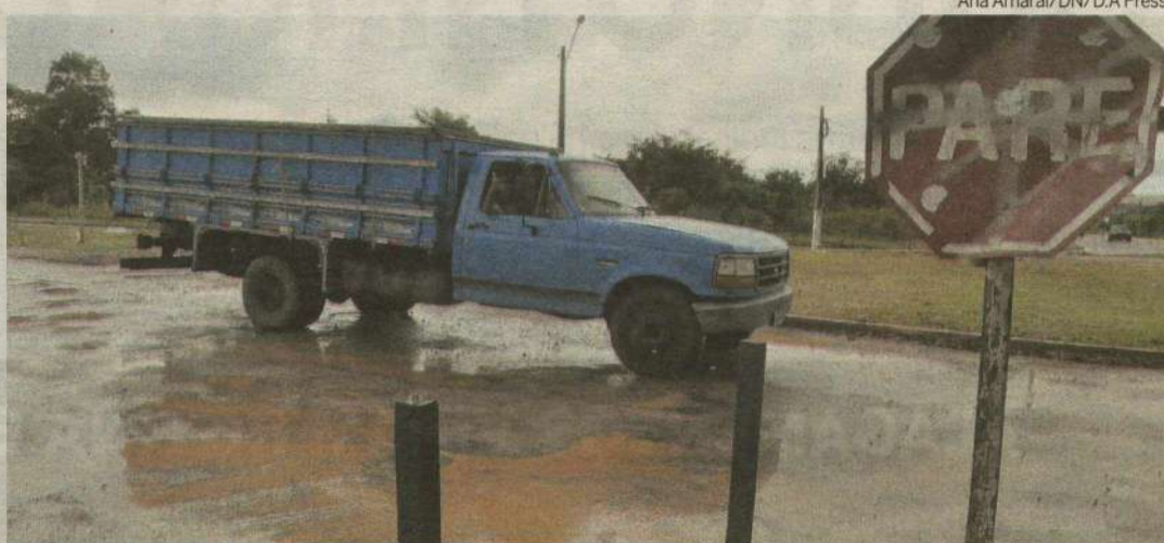
Devido as chuvas, avenida que dá acesso à Coophab, em Nova Parnamirim, perdeu quase todo o asfalto
